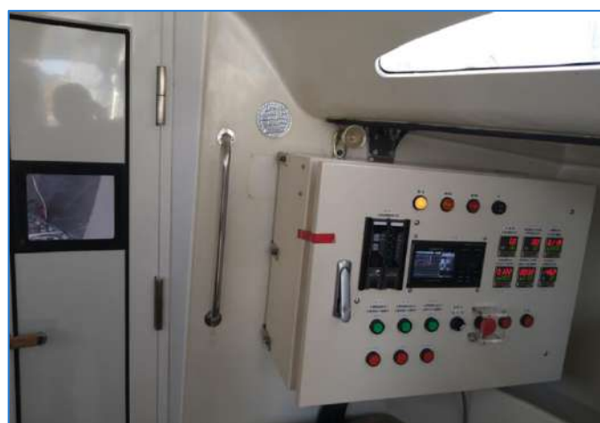
水素機器制御パネル
