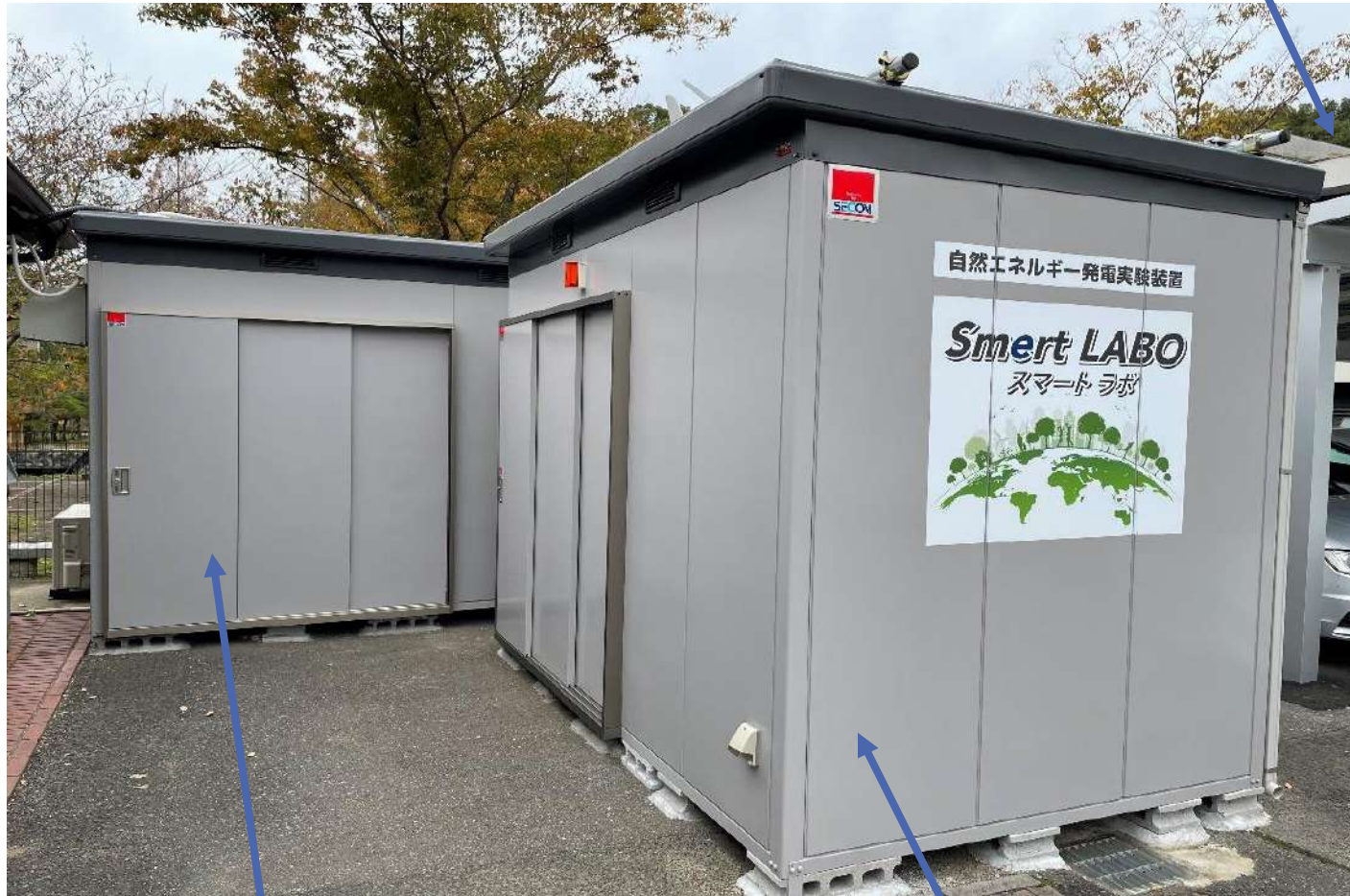
水素系統制御棟
