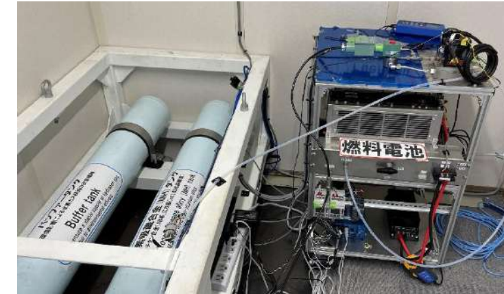
水素燃料電池設備
