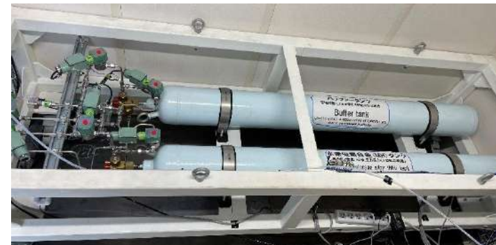
水素系統制御機器 水素貯蔵(吸蔵合金)
