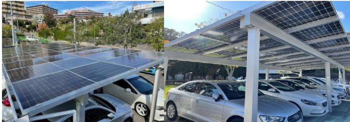
太陽電池パネル発電設備
