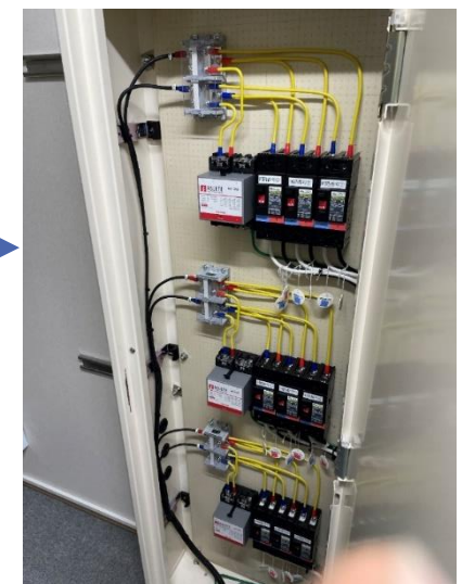
太陽電池電力配電盤
