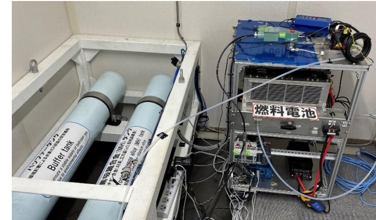
水素燃料電池設備
