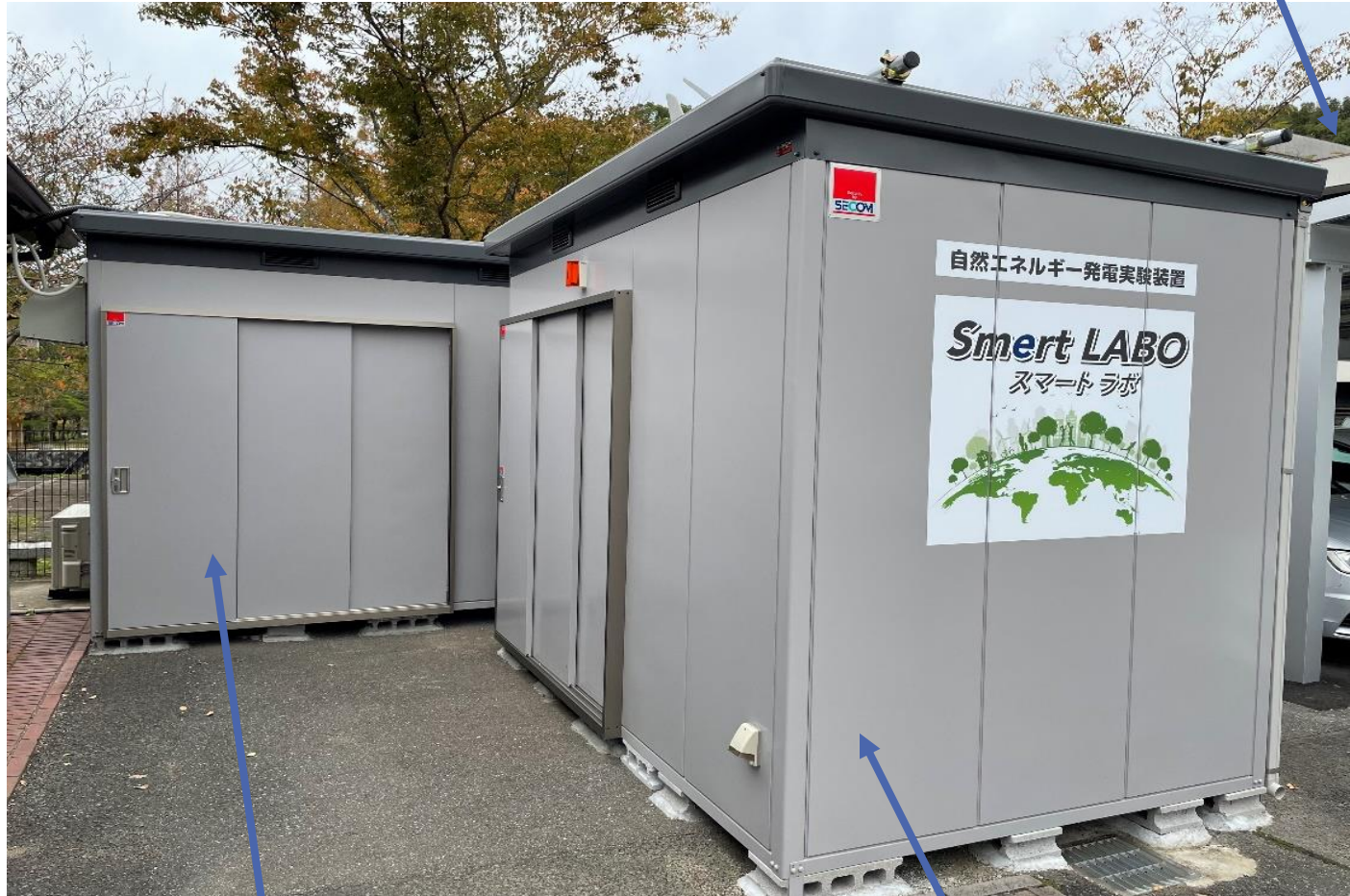
水素系統制御棟
