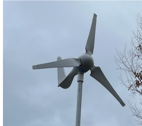
風力発電設備
